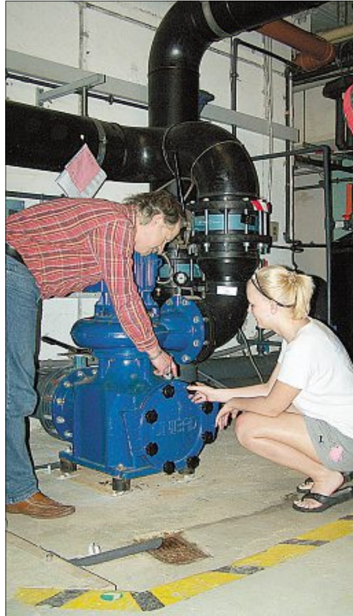
Badmitarbeiter Achim Pönack erläutert Sabrina Kruse die Wartung der Freibadpumpe im Technikeller. Caglar
