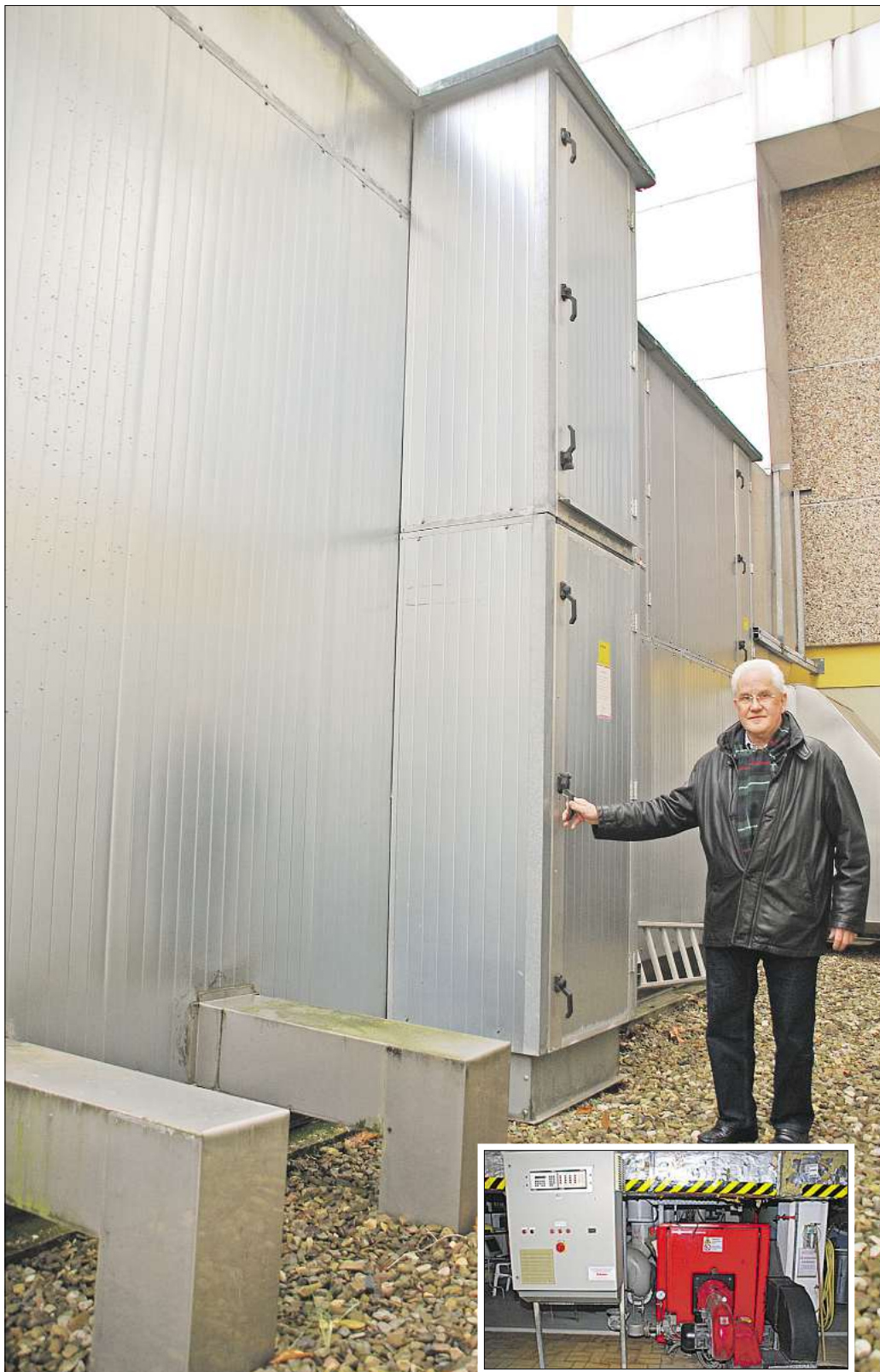
Veraltete Technik am Schwimmbad: Henning Hirschmann steht an der Lüftungsanlage (großes Bild), die in die Jahre gekommen ist. Auch die Heizung (kleines Bild) soll ausgetauscht werden. Naumann (2)
